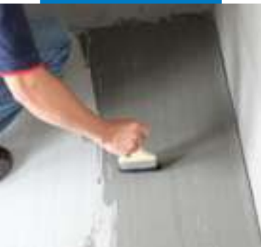
Hình ảnh làm ẩm bề mặt do bề mặt thi công quá khô
